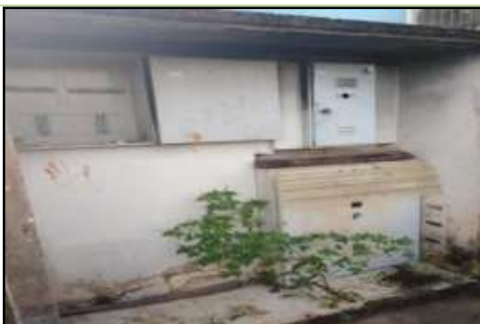
Figura III – Casa de Máquinas
