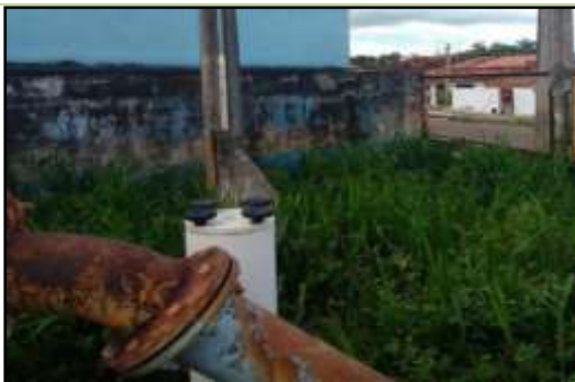
Figura I – Rede de Distribuição
