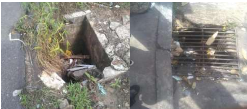
Figura 45– Obstrução de Vias de Drenagem devida à quantidade de lixo nas ruas. Fonte PMSB.
