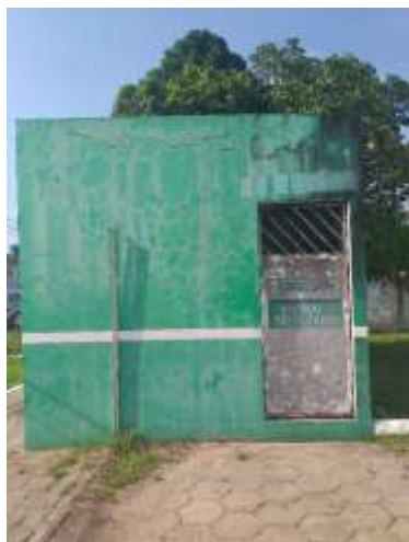
Figura 7 - Abrigo externo de resíduos infectantes e perfurocortantes UPA 24 h
