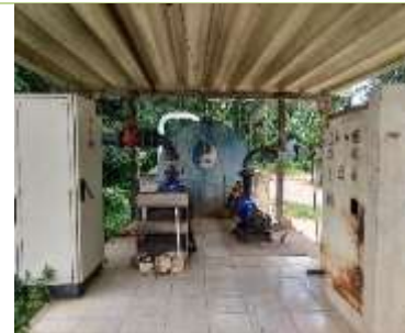
Figura III – Casa de Máquinas
