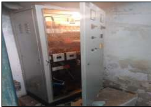
Figura III – Rede de Distribuição de Energia
