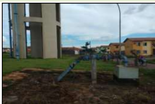
Figura I – Rede de Distribuição
