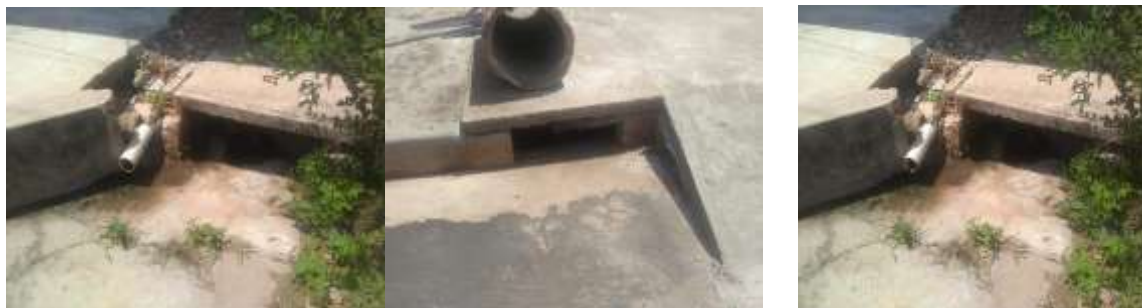
Quadro 27 - Rede de drenagem presente na Av. Paulo Titan.
