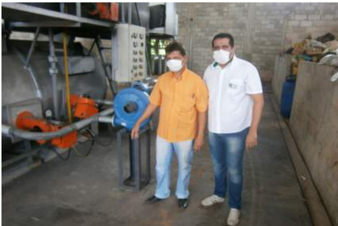
Imagem 148: Painel de Controle e Aerador
