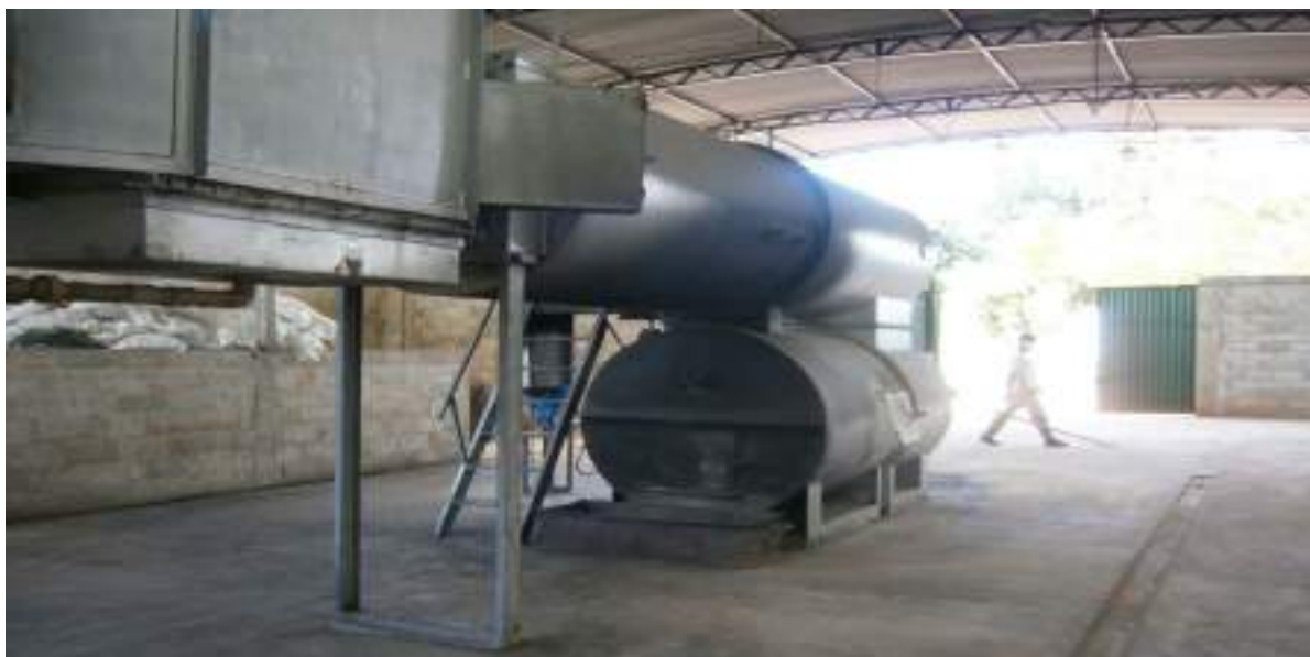
Imagem 150: Incinerador, filtro de gases e cortina d'água.
