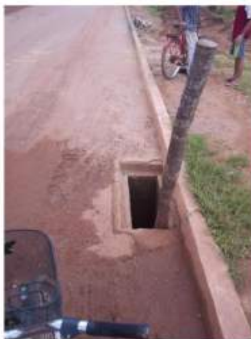
Foto nº 60: Bueiro com tora de madeira
