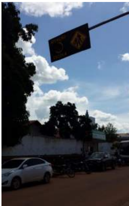
Foto nº 76: Semáforo de advertência na Rua Teotônio Vilela
