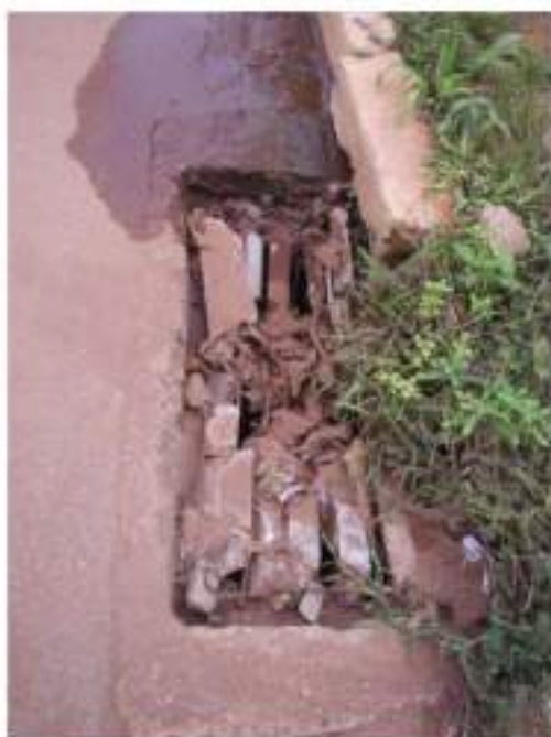
Foto nº 59: Bueiro com entulhos
